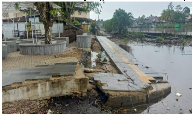
Gambar 1. Waterfront yang terlihat rusak dan patah
